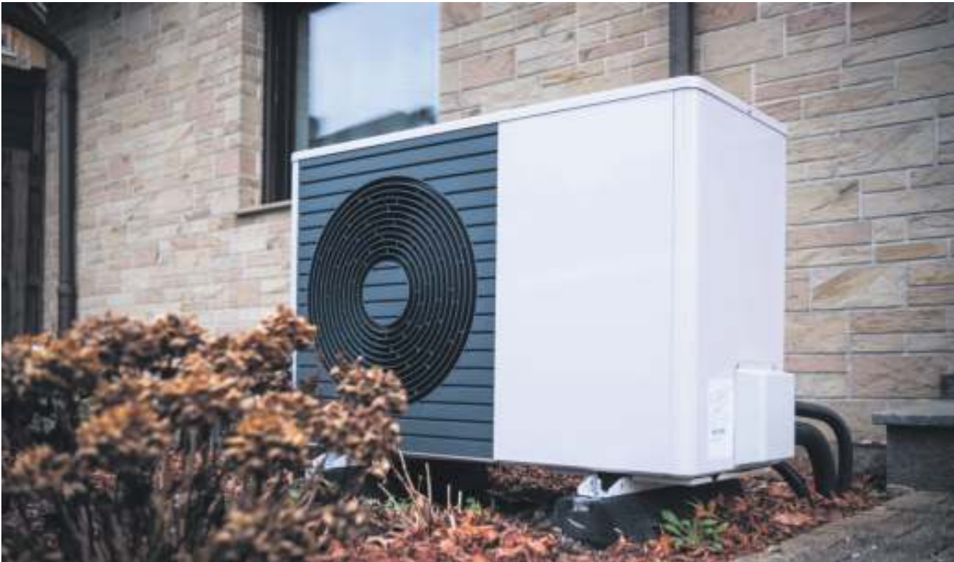
Eine Wärmepumpe ist mittlerweile Standard beim Neubau, wird aber auch immer mehr in Altbauten integriert.
