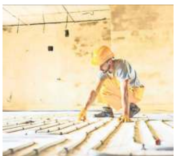
Eine Fußbodenheizung lässt sich auch in älteren Eigenheimen nachträglich installieren.
